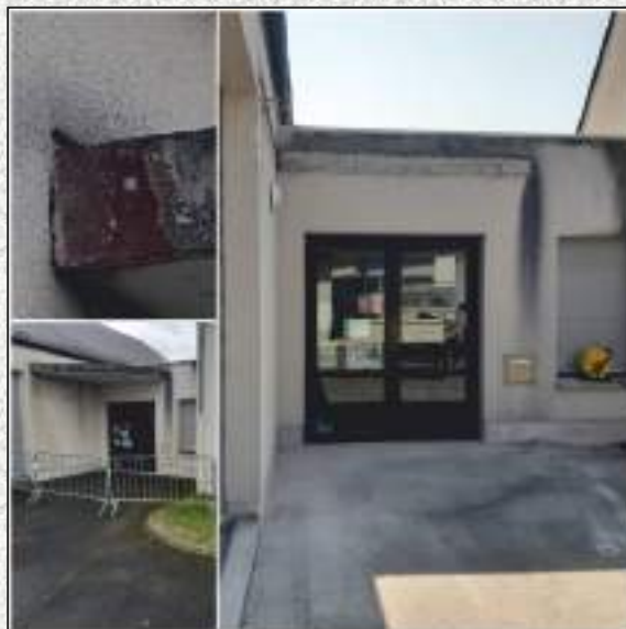
La « casquette » à l'entrée de l'école menaçait de s'effondrer. Elle a donc été complètement supprimée.
